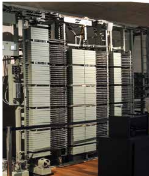
Sector de Central AGF Ericsson que dio servicio desde 1926 a la telefónica municipal de San Sebastián en la calle San Marcial. Dispone de algunos sectores modernizados (Vista parcial de los bastidores preservados en el Museo de S. Telmo que con anterioridad lo habían estado en el Museo de la Ciencia de San Sebastián).
