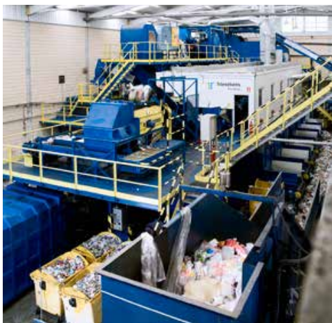
Planta de tratamiento de envases de la Mancomunidad de S. Marcos. (Fotografía: Mancomunidad de San Marcos).
