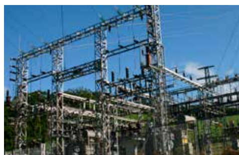
Subestación de Igara.
