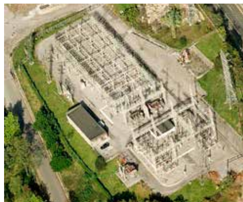
Subestación de Martutene. Fot. Diput. F. G.
