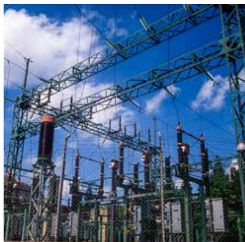
Subestación de Errondo.
