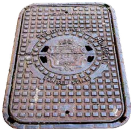
Tapa de un registro en la acera de la Telefonica Municipal. Todas ellas están seccionadas por la mitad por razones de seguridad de los operarios.
