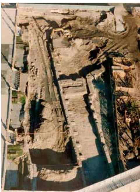
Foso, camino cubierto y contraguardia de San Felipe, estructuras demolidas para construir un aparcamiento subterráneo. (Fot. Diputación Foral de Gipuzkoa).
