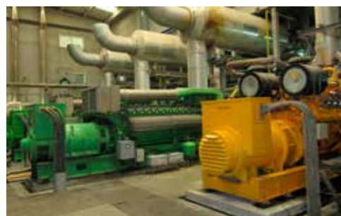
EDAR de Kapuene. Central eléctrica. Los generadores de color verde (en número de tres) son de gas y los amarillos (2) de biocombustible producido en la propia Planta.
