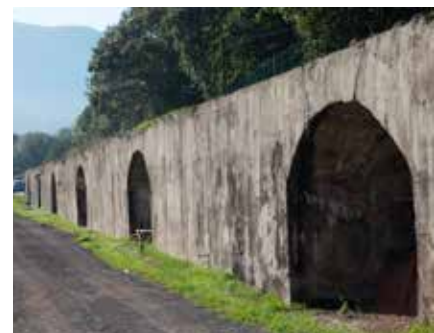
Estado de los hangares en 2016.
