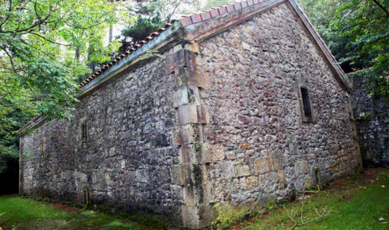
fachadas norte Izda.) y este (dcha) con sus conductos de aireación.
