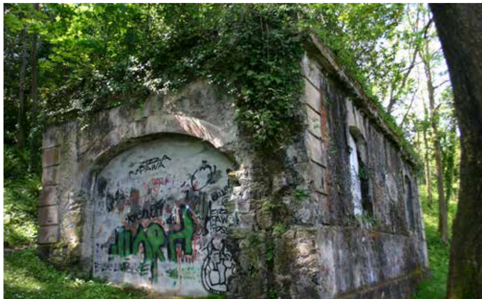
Pabellón de abrigo y guardablancos. Vista tomada desde el este. El arco originariamente estaba abierto. Actualmente está cerrado por medio de un tabique
