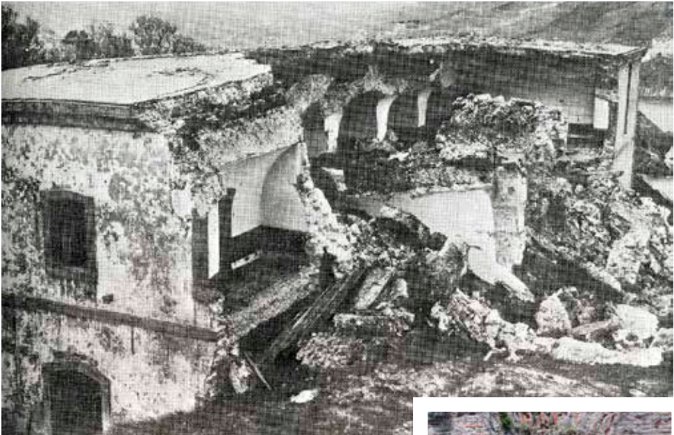
Estado del cuartel tras la demolición parcial.
