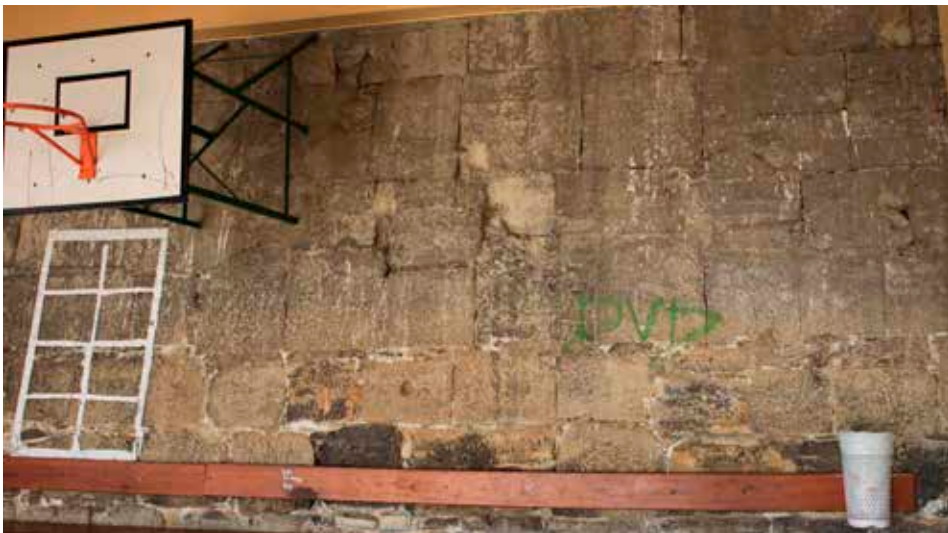
Muro de sillería de buena factura que sostenía el terraplén de la batería superior. Actualmente integrado como muro de contención en el patio de recreo de la planta baja de la ikastola.
