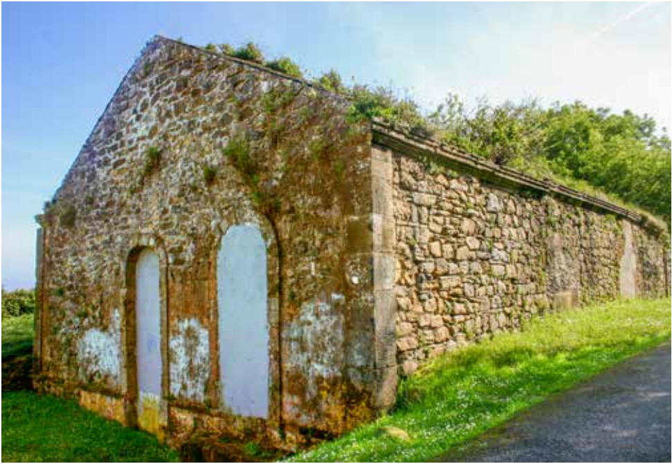
Fachada occidental, con la puerta y la ventana, precedidos antaño por un porche y la fachada meridional, con dos ventanas.
