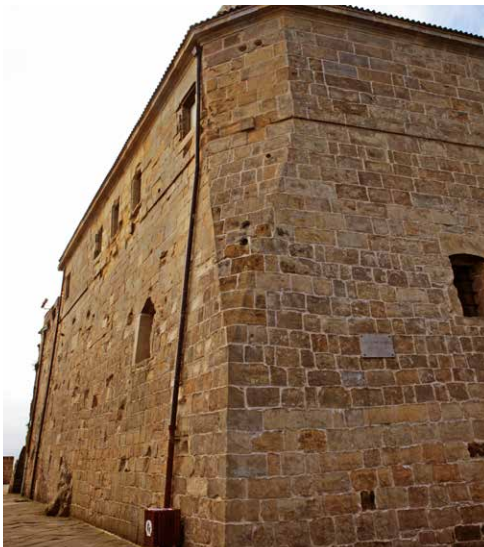
Macho en su parte rectilínea. Nótese el paso de esquina angular de la parte baja a achaflanada en la superior. Se observan también algunos posibles impactos de proyectiles.
