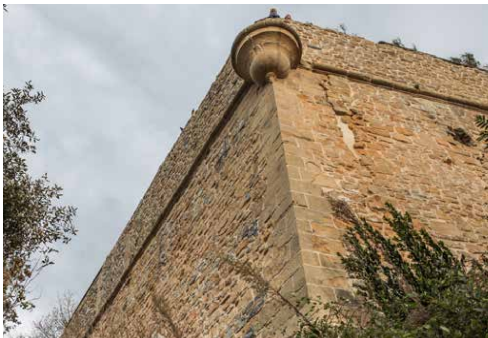
Ángulo de la batería visto desde el exterior. Se aprecia el cordón, los sillares del esquinual y del del remate circular, así como una grieta de cierta importancia que parece reparada.
