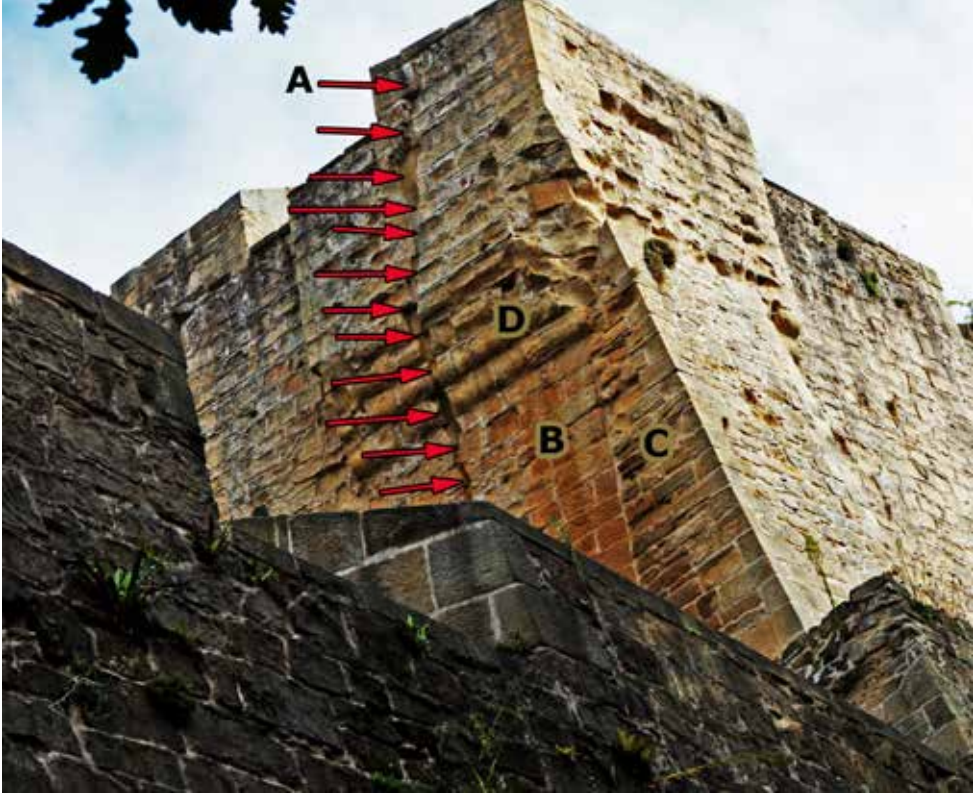
Ángulo SW. A: grieta estructural reparada. B: Lienzo original de la muralla. C: Contrafuerte añadido. D: Volado y sujeción decorada con cuatro molduras.
