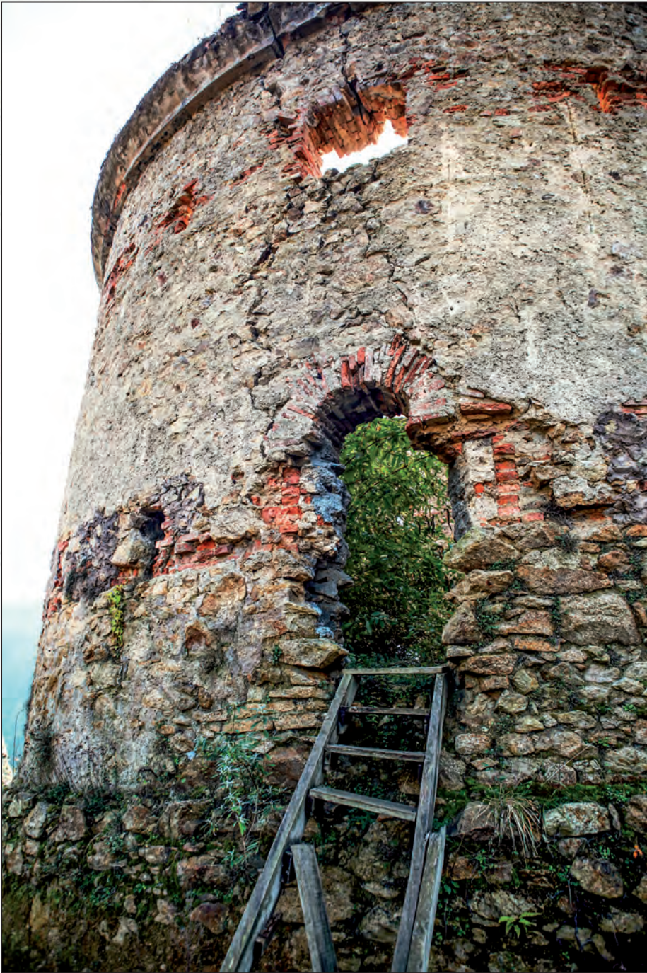
Exterior de la torre en el que se aprecia rasgada una lucerna para realizar un acceso improvisado.
