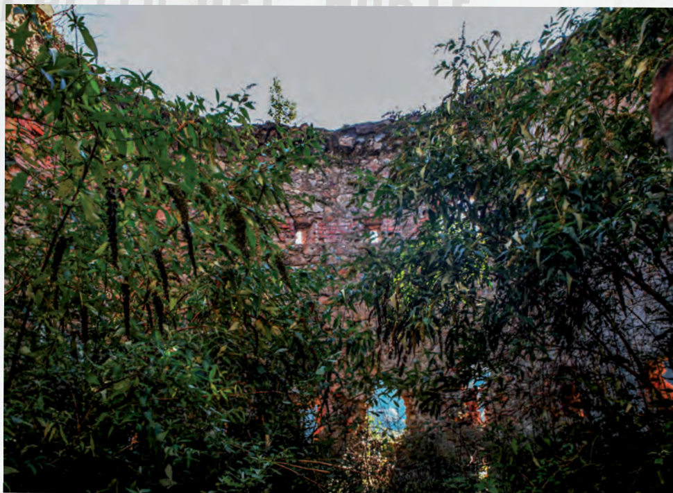
Fotografía del interior de la torre, invadida por la vegetación,
