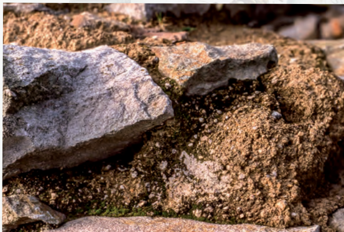
Detalle de la mampostería de los muros del fuerte. Se aprecia la descomposición del mortero, convertido en muchos lugares en barro que une los mampuestos, explicándose así el rápido proceso de ruina a que se ha visto sometida la fortificación.
