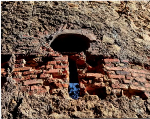
Torre de Endarlatsa . Aspillera y pequeño óculo sobre ella. Se aprecia la presencia del enfoscado de revestía toda la fachada
