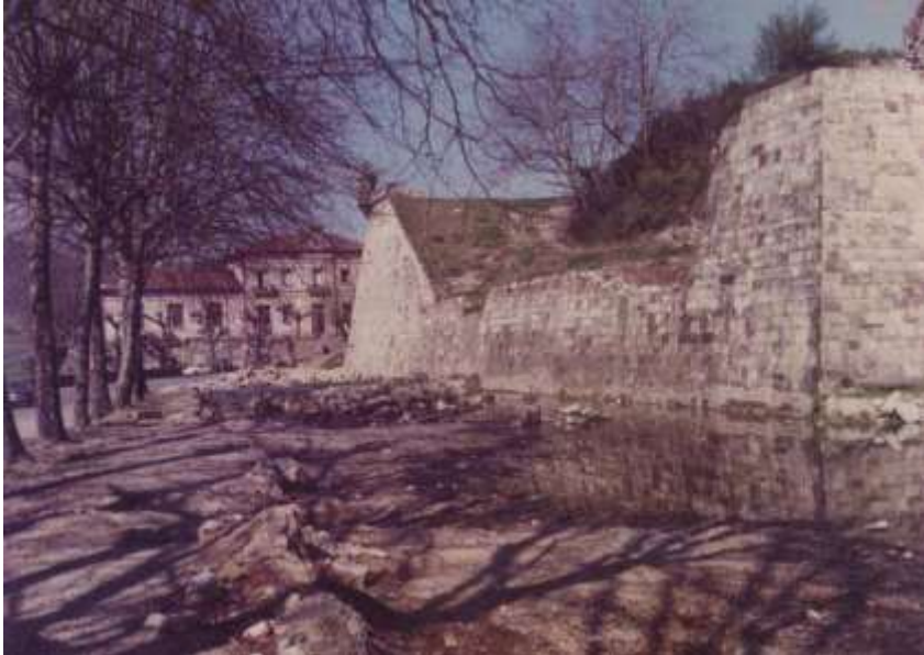
Baluarte de la Reina. Trabajos de restauración y mantenimiento. Foto: Archivo de la Diputación Foral de Gipuzkoa: Portal: Gure Gipuzkoa.
