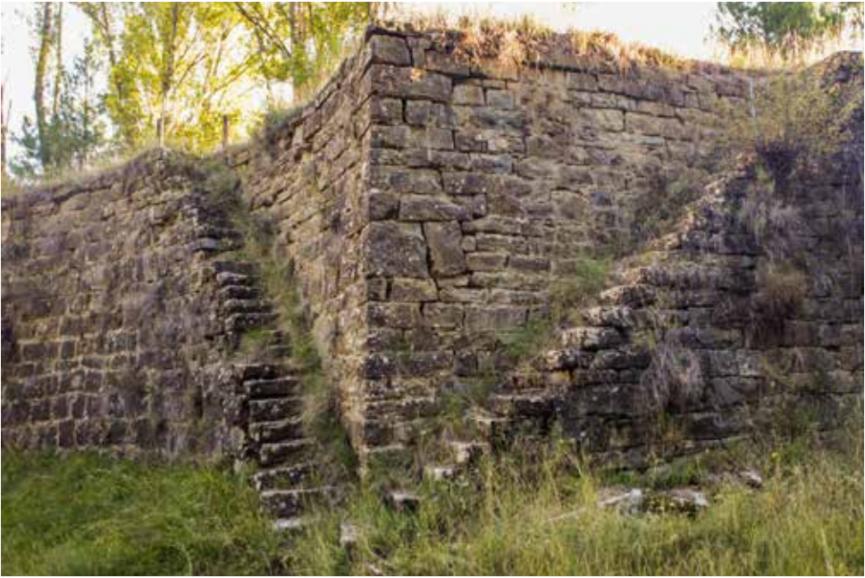
Escaleras 5 y 6, formando ángulo en la contraescarpa, frente a la caponera de cabeza. Su estado, al igual que las 3 y 4 es malo.
