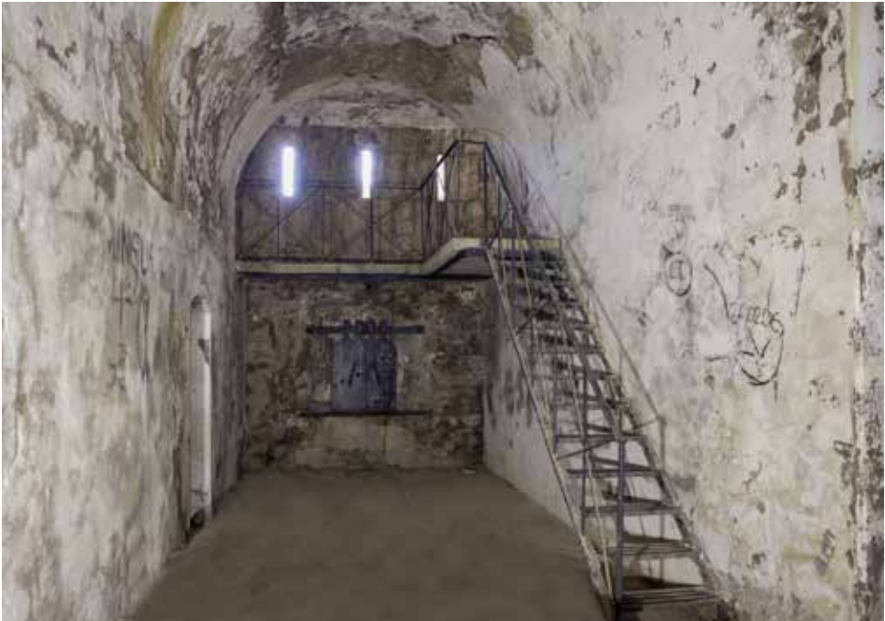
Las escaleras son metálicas y están en buen estado. La pasarela de servicio para el segundo orden de fuegos tiene también estructura metálica.
