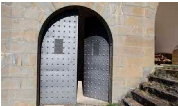
Abrigo. Puerta metálica de dos batientes con rejilla de aireación en cada una de ellas.
