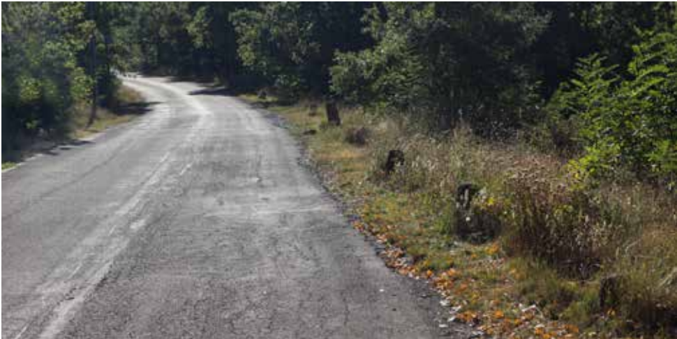
Estado actual de la carretera. A la derecha se aprecian los guardarruedas.
