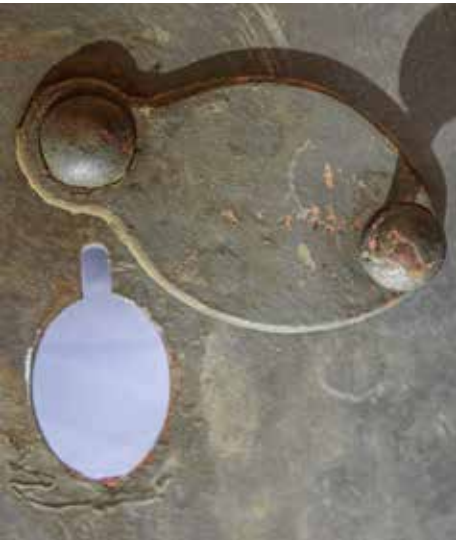
La puerta posee cuatro aspilleras/mirillas con su correspondiente cierre que permite contribuir a la defensa del espacio intermedio entre la poterna y la caponera.
