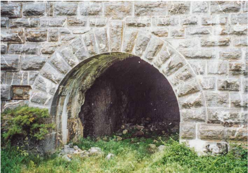
Santa Elena, Casamata inferior, excavada y con el paramento revestido, pero sin realizar la cañonera.
