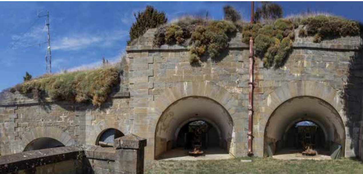
De izquierda a derecha. casamata n. 1 y abrigo (semiocultos por el pretel) y casamatas n. 2 y n. 3.
