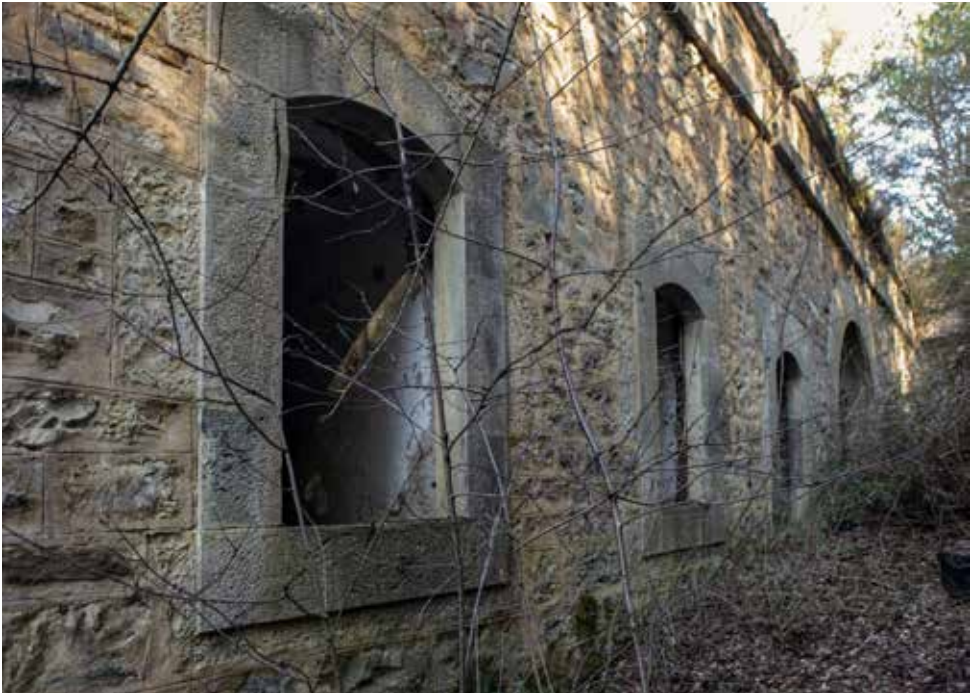
Dos ventanas y puerta del cuerpo de Guardia. Al fondo la casamata oriental, vistos desde la calle de servicio.
