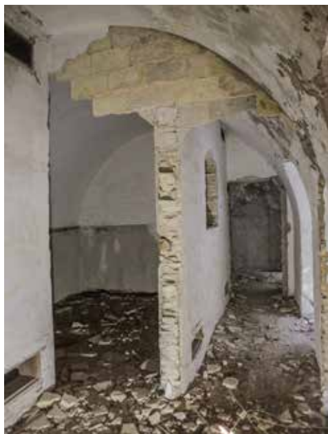
Bóveda subdividida mediante tabiques en el cuarto de carga (8, primer plano). Detrás, el almacén de pólvoras(7). Al fondo se encuentra el almacén de víveres (9).
