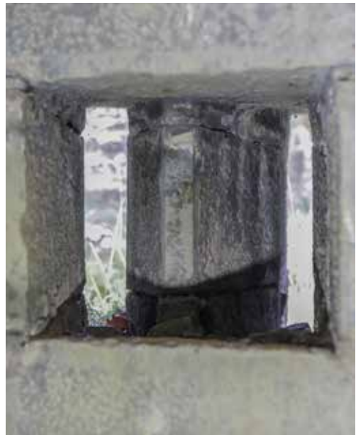
En las galería aspilleras encontramos alguna aspilleras dobles que evitan ángulos muertos: una entrada y dos salidas.
