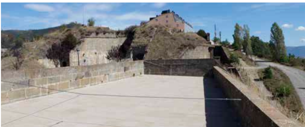
Sector oriental de la azotea con parapeto de fusilería que rodea la mayor parte de la cubierta del Cuartel. El suelo embaldosado en intervención del año 2018 es el causante de la disminución en más de 20 cm de la altura del parapeto original, perdiendo sentido de su función..
