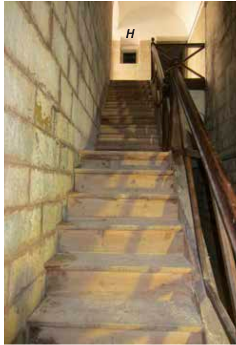
Escalera entre las dos estaciones del montacargas. Se observa el nicho de luces (H) del cuarto de carga y montacargas.
