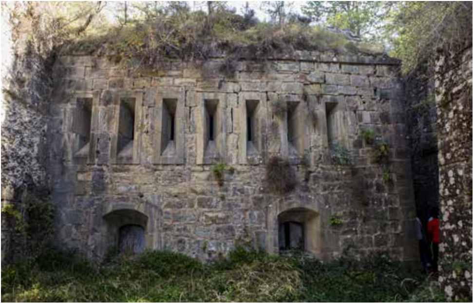
Uno de los frentes de la caponera de cabeza. Abajo orden de fuegos artilleros, encima un segundo orden fusilero (7 aspilleras) y sobre éste, al descubierto, otro tercero de fusilería.
