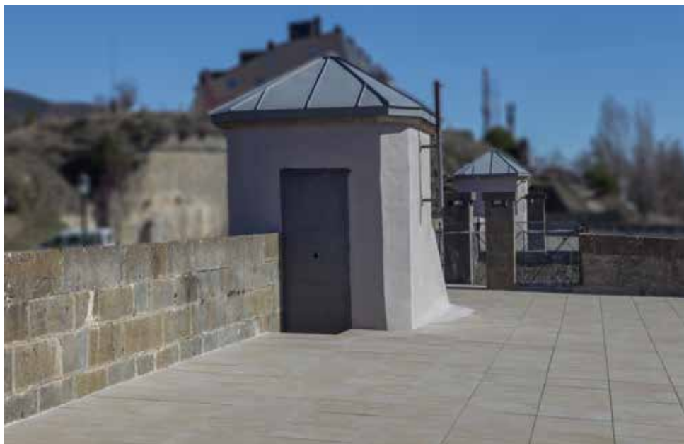
Casetón que cubre la caja de la escalera occidental que comunica las dos plantas del cuartel con la azotea aspillerada. La altura del parapeto original era mayor, quedando ésta disminuida tras la actuación llevada a cabo en 2018.
