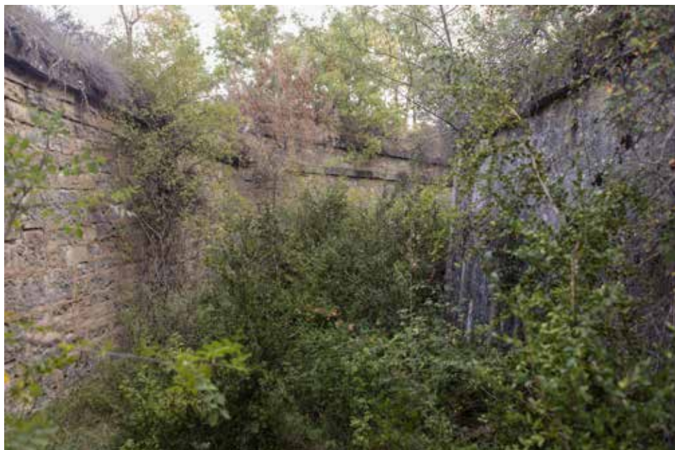
Interior de la batería. a la derecha el muro de revestimiento del desmonte del terreno natural y a la izquierda el revestimiento en el que se abren casamatas y resto de las dependencias.
