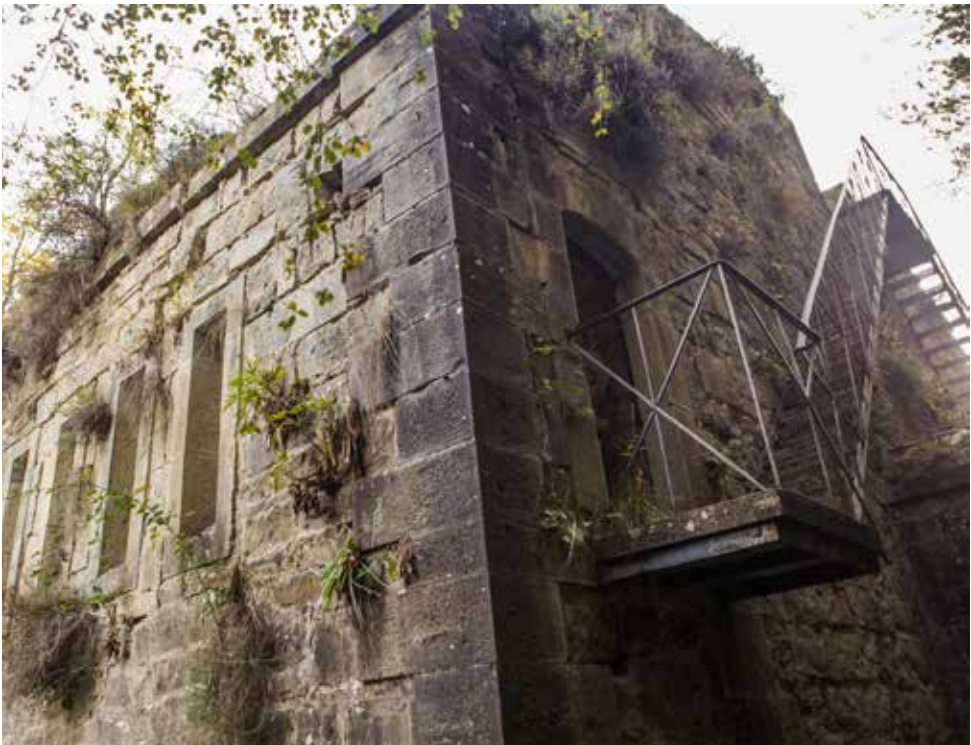
Desde la galería del segundo orden de fuegos se puede salir al exterior y por medio de una escalera metálica subir a la azotea que constituye el tercer orden de fuegos.
