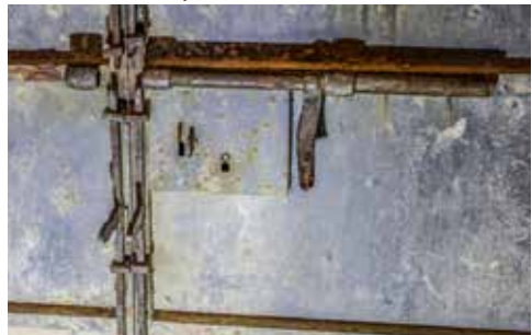
Cerradura y cerrojo de la puerta metálica de salida de la caionera de cabeza al foso
