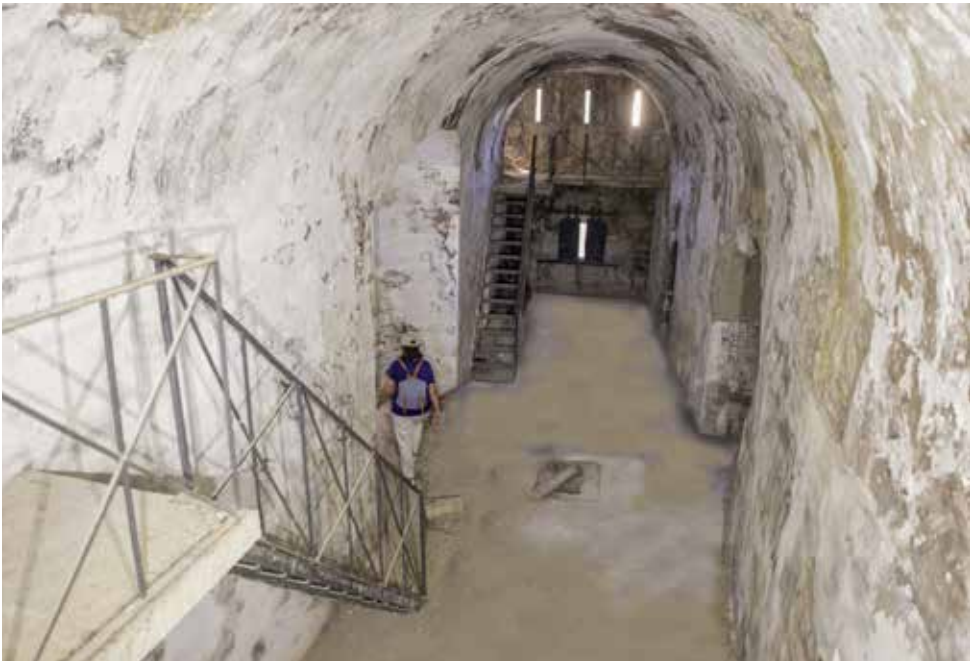
Una de las casamatas de la caponera, fotografía obtenida desde la plataforma de las aspiradoras A la izquierda, la entrada y a la derecha el paso a la siguiente casamata.
