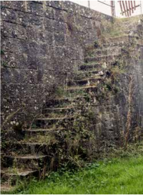
Escalera 1, frente al cuarte. Es corta debido a que el foso es también poco profundo.
