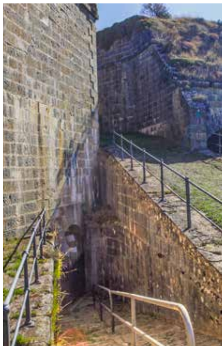
Rampa de acceso a la semicapонера oriental. A la derecha rampa a casamatas
