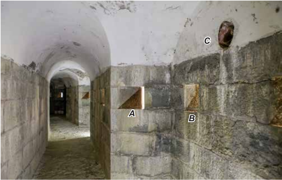
Galería de fusilería de la caponera e cabeza. Presenta siete entrantes que permiten incorporar aspilleras (A) capaces de disparar sobre en foso en mejores condiciones que las convencionales (B). Incluye, además, diversos conductos de ventilación (C)
