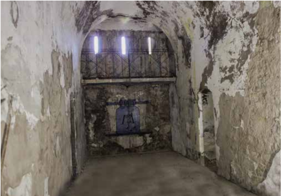
Casamatas de la caponera de gola cada frente tiene dentro de la bóveda dos ordenes de fuego: el inferior de artillería y el superior, con acceso por escalera metálica, de fusilería.
