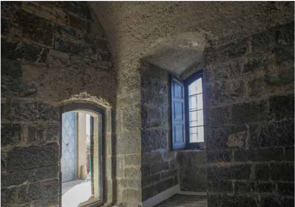
Cuerpo de guardia para tropa. Nótese la bóveda de hormigón y estribos de piedra.
