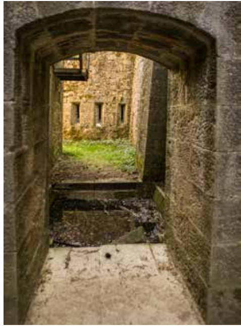
Puerta 4 de acceso al foso en la caponera de cabeza, visto desde el interior. Se aprecia el fosete (o foso diamante) inundado a pesar de que está pensado como seco.
