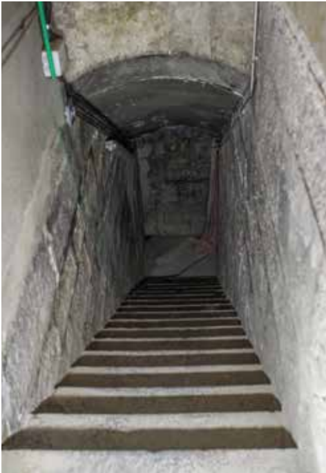
Escalera que partiendo del cuerpo de guardia conduce a la caponera de gola, a dos puertas de salida al foso y al aljibe.
