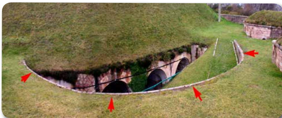
Las flechas señalan el zócalo donde estuvo instalada la barandilla original, actualmente desaparecida. Se pueden apreciar en la piedra los orificios que acogían los postes.
