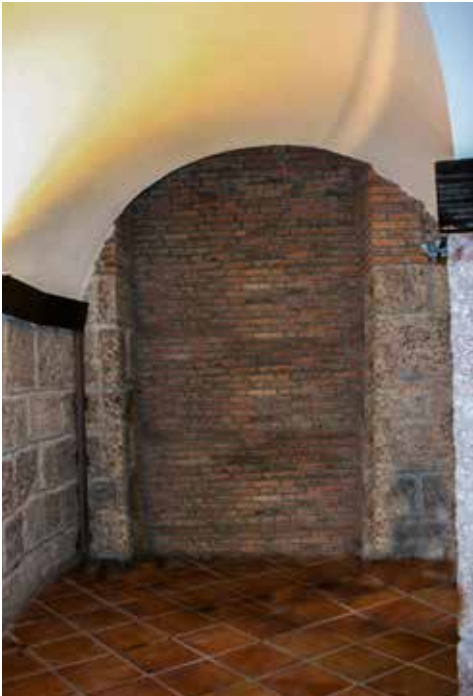
Estación inferior del ascensor de pólvora, situado al lado del almacén. únicamente se conserva la caja que acogía los elementos mecánicos.
