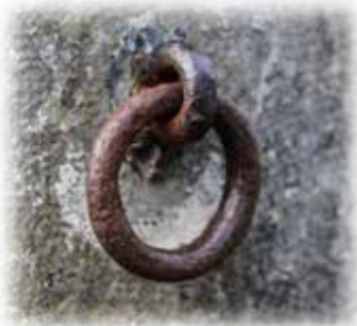
Argolla para cierre de la embocadura mediante una cadena entre los dos hitos.
