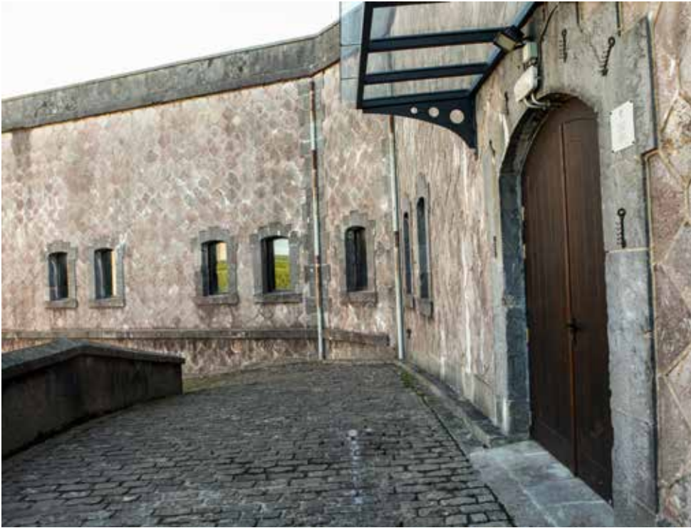
Final de la rampa que comunica el patio de armas con la puerta (en primer plano) de la batería acasamatada. Se observan las ventanas pareadas de las casamatas.
