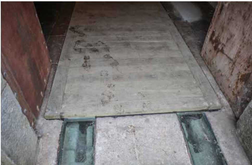
Réplica aproximada del puente móvil del ala de la semicaponera aparece replegado.
