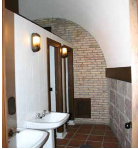
Vista longitudinal del almacén. Al fondo se aprecia el muro de ladrillo con los ventiladores, a la derecha el muro original y a izquierda los servicios incorporados.
