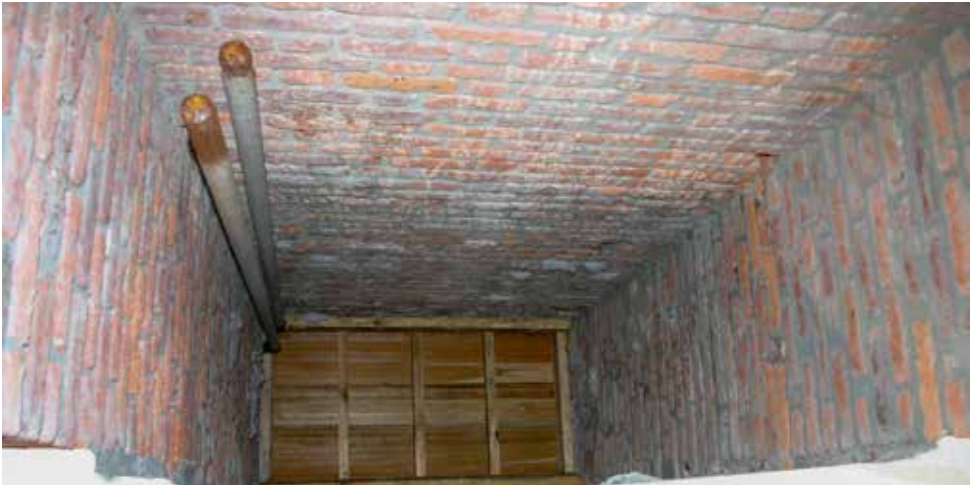
Caja del ascensor de proyectiles vista desde la estación inferior. Está cerrado por una estructura de madera en el suelo de la estación superior.
