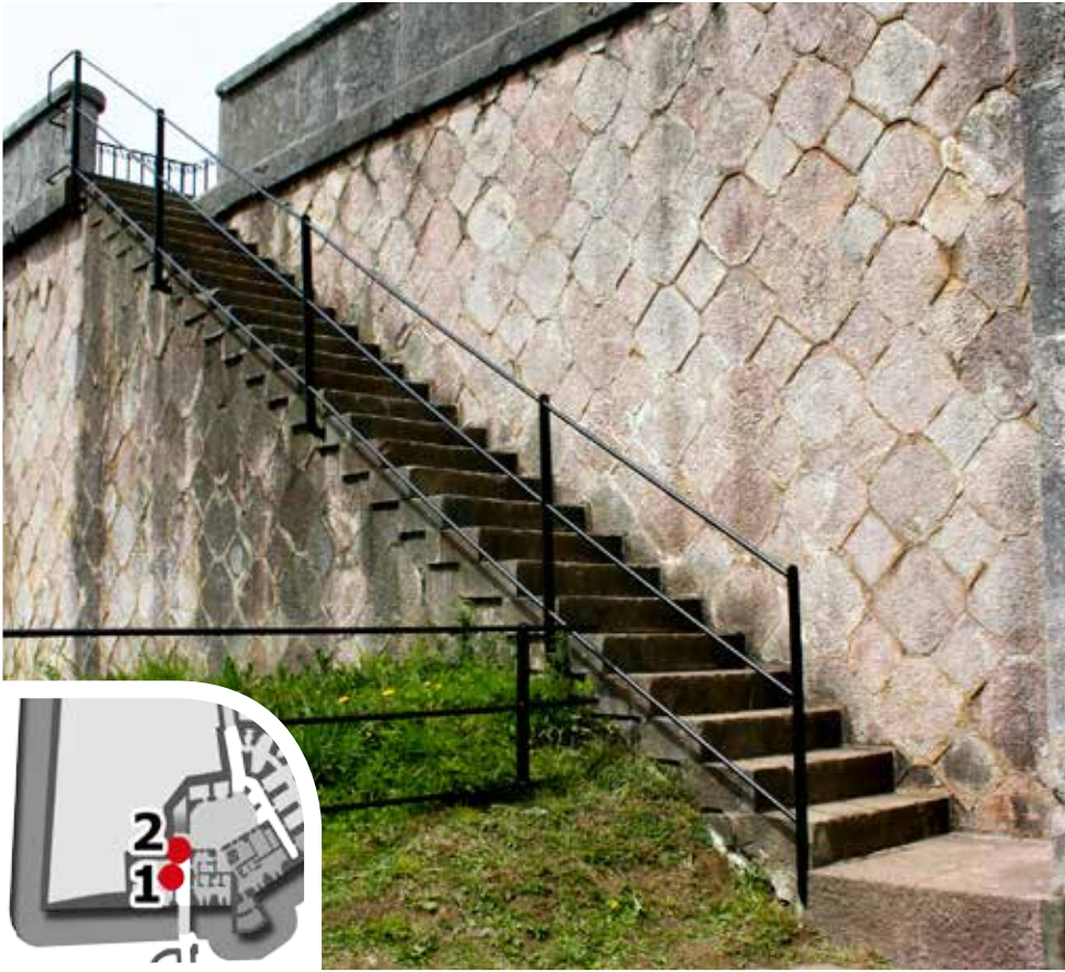
27 escalones (1) que unen los parapetos de fusilería de gola y el establecido sobre la batería acasamatada.
