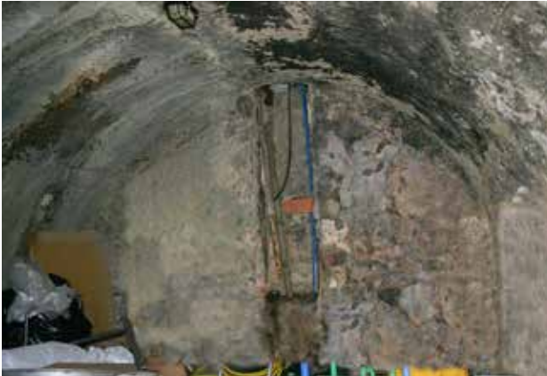
Interior de la antigua cocina de tropa. Se observa, n en la pared de fondo los vestigios de la chimenea de la cocina. Actualmente se utiliza como almacén.
