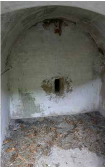
Uno de los repuestos pequeños asignados a municionar una sola pieza de artillería. En el centro se aprecia uno de los conductos de ventilación.
