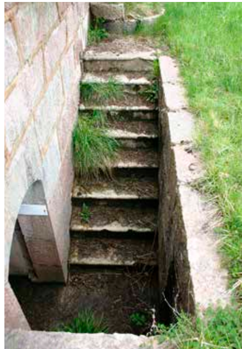
Con objeto de aumentar la seguridad del repuesto, el suelo de los mismo está a cota inferior que el adarve de combate, accediéndose por medios de escaleras.
