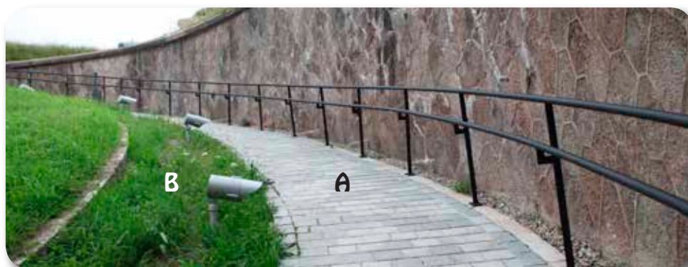
Pasamanos cumpliendo normativa para discapacitados, de dudosa adecuación estética. El error más grave percibible en la fotografía es la pavimentación de solo una parte de la rampa (A), quedando distorsionada la misma al dejar otra parte revestida de césped (B).
