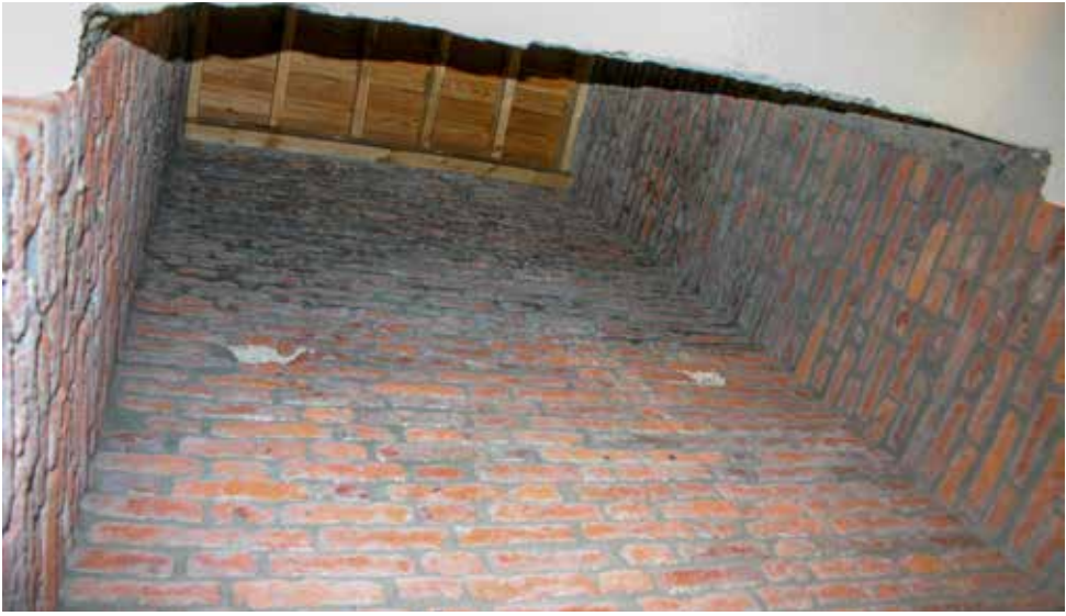
Caja del ascensor de pólvora vista desde la estación inferior. Está cerrado por una estructura de madera en el suelo de la estación superior.
