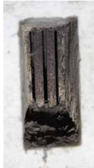
Flejes metálicas que impiden la entrada por los aireadores de cualquier elemento extraño.
