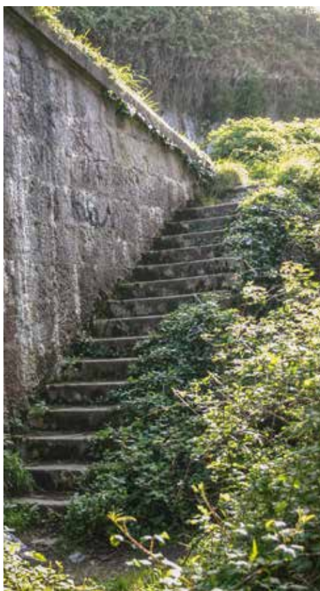
Escalera de acceso al foso del cuartel en su tramo occidental.. Se aprecia claramente el cordón de la contraescarpa.
