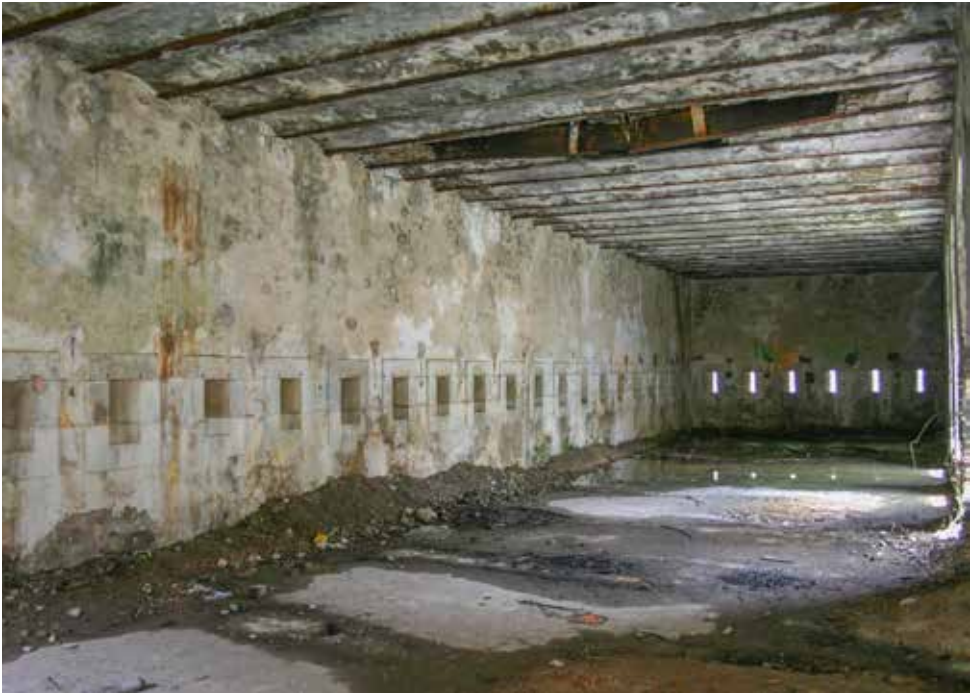
Dormitorio de tropa (6). Se aprecian las aspilleras y la disposición de los perfiles metálicos que forman la cubierta plana.
