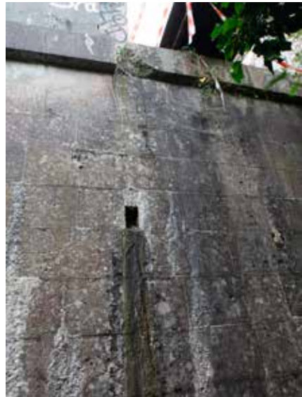
Uno de los orificios de drenaje de la caja de mecanismos del puente.
