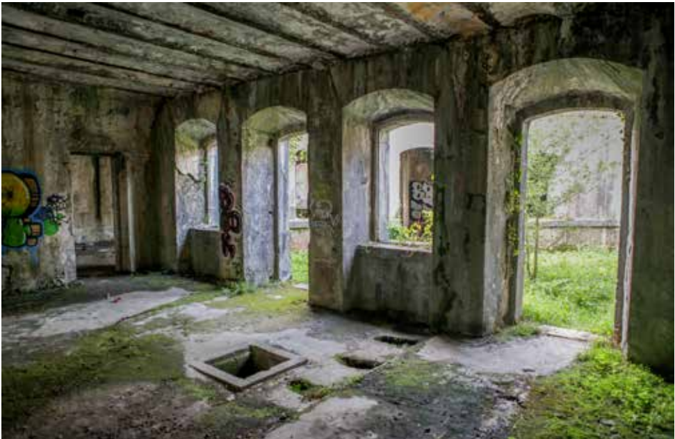
Vestigios de los excusados (5) y del registro del pozo Mouras para depuración de las aguas y almacenamiento de las deyecciones. A la derecha acceso y ventanas al patio. Faltan tabiques que individualizaban los espacios.
