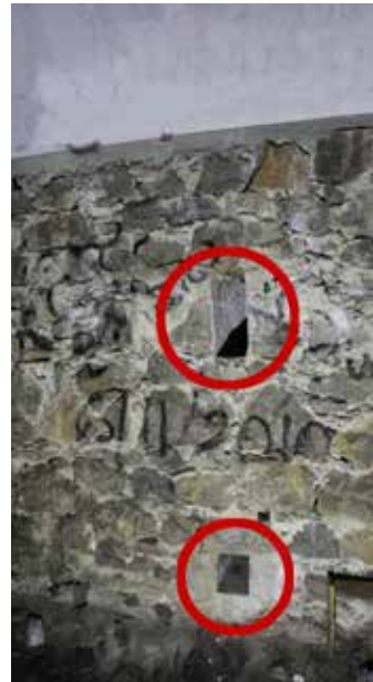
Conductos de ventilación superior e inferior en el interior del almacén.
