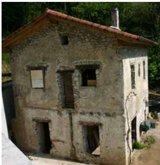
Estado del edificio en el año 2005, obtenida durante el proceso de rehabilitación, permitiendo observar la mampostería.
