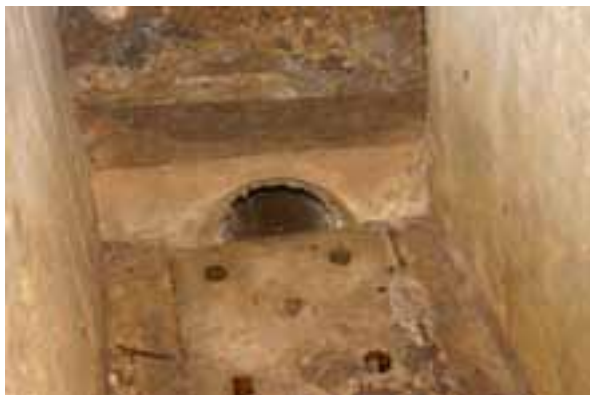
Fig. 9: Sumidero, provisto de una tapa agujereada, para el drenaje de las galerías. Normalmente se encuentran a la entrada de nidos y refugios. El de la fotografía corresponde a la obra n. 2.
