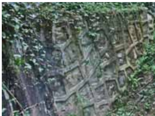
Fig. 63: Obra n. 23. Detalle de la imitación a mampostería encintada, probablemente con objeto de evitar la reflexión solar del hormigón liso que podría descubrir la obra a la fotografía aérea.
